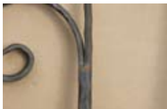
接合部や溶接部分に発生した「サビ」
